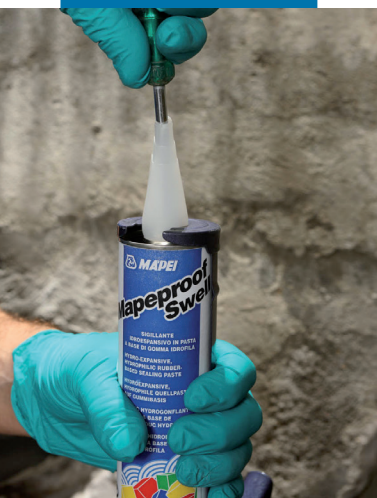
Perforación de la membrana de protección de Mapeproof Swell
